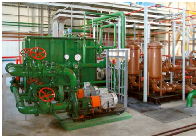
Kompressorová stanice Bar byla uvedena do provozu v roce 1979, má 7 kompresorových jednotek s celkovou kapacitou 70 000 kW.
