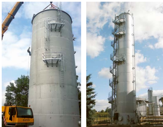
První IC reaktor o celkovém objemu 340 m 3 je instalován na ČOV v potravinářském závodě DANISCO Smiřice. Druhý o celkovém objemu 1050 m 3 pak na ČOV v cukrovaru v Českém Meziříčí.
