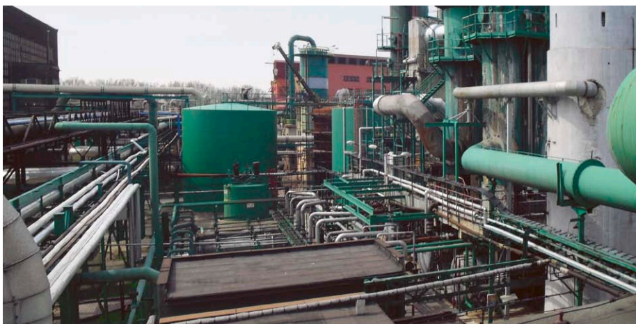
Akce pod heslem „Precheza“ propukne ve výrobním závodě v Přerově v září 2012.
