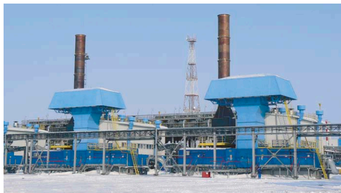
Kompresorové stanice na ložisku Južno-Ruskoje.
