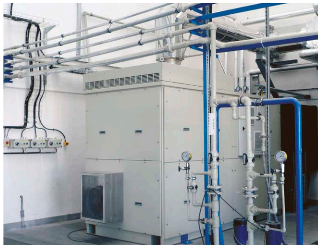
Kogenerační jednotka připravená ve Vestci ke zkouškám.
