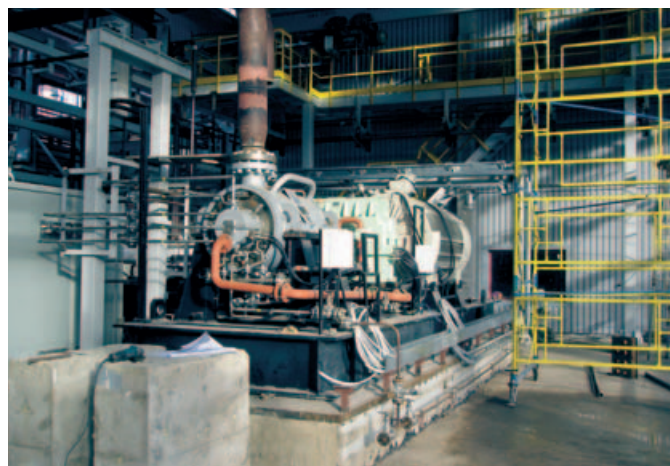
Turbokompresor z produkce ČKD NOVÉ ENERGO na stlačování vodíkového plynu.
