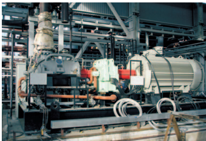
Soustava kompresoru poháněná asynchronním elektromotorem včetně převodového ústrojí.
