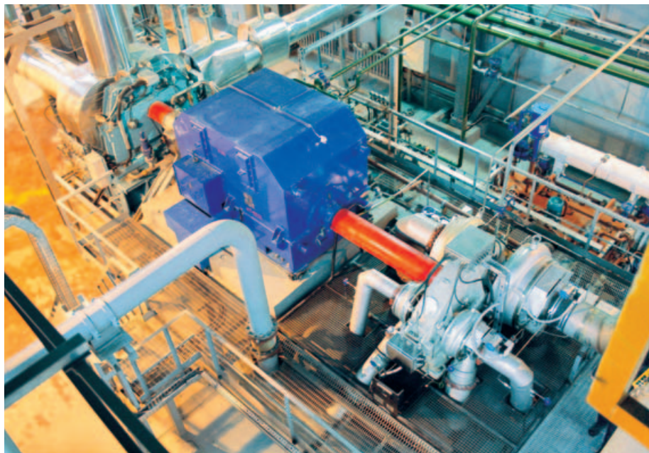
Dodávka kompresoru z ČKD NOVÉ ENERGO pro GRODNO AZOT byla významná kvůli špičkové kvalitě provedení a montáže
