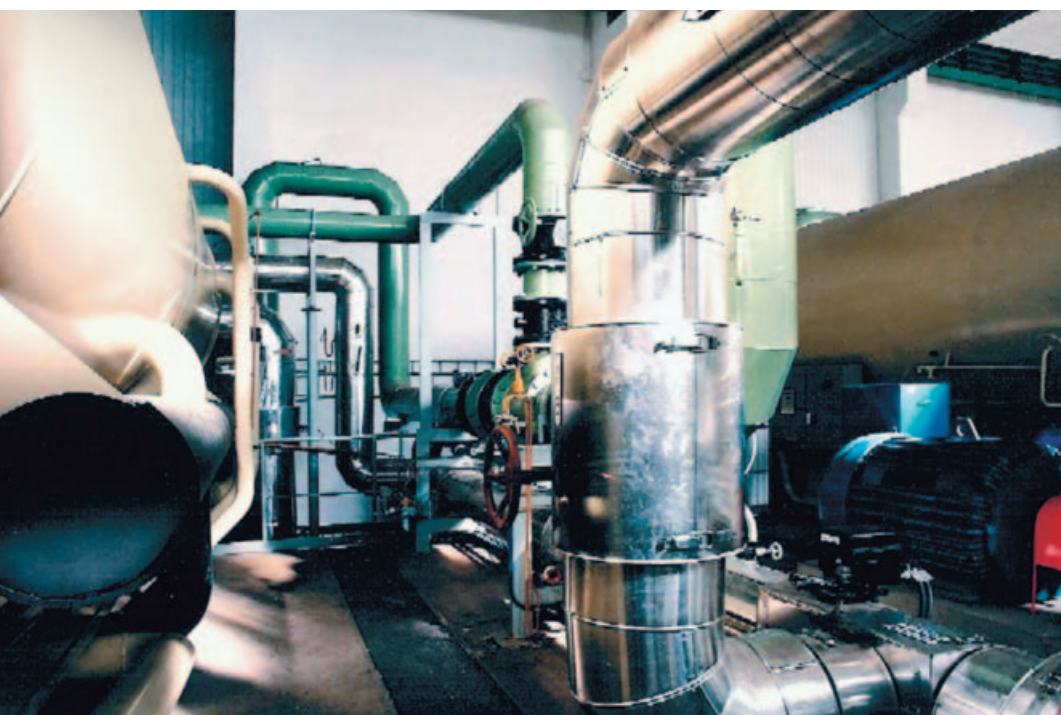
Jaderná elektrárna Temelín – rozvody chlazené vody
