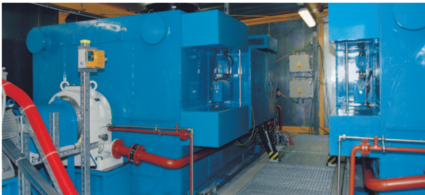
Instalované setrvačnickové generátory mají vlastní halu, která je kryje před povětrnostními vlivy.
