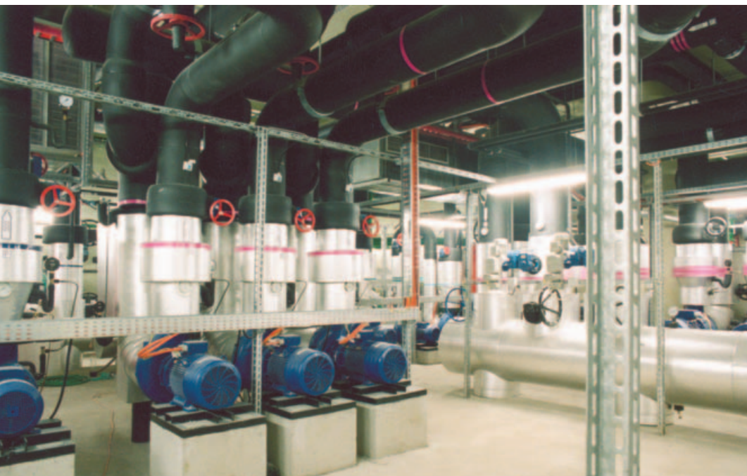
Strojovna klimatizace O 2 Areny, ve které společnost ČKD PRAHA DIZ realizovala kompletní dodávku klimatizačního zařízení.
