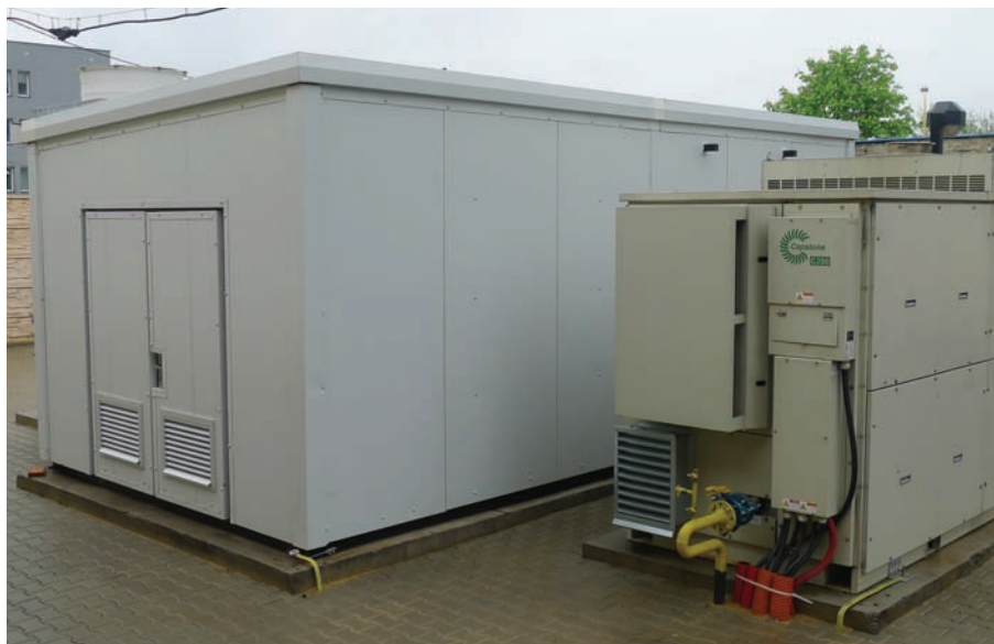
Когенерационная установка с микротурбиной «Capstone» обеспечит машиностроительному предприятию в Остраве снабжение электроэнергией и холодом
