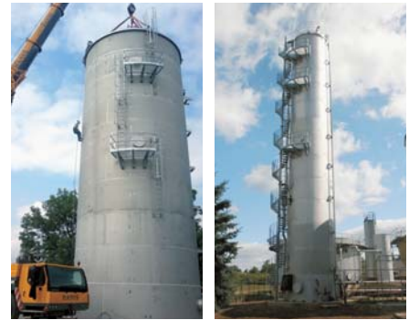
Первый IC-реактор общим объемом 340 м³ установлен на очистной станции продуктового завода DANISCO в г. Смиржице. Второй реактор общим объемом 1050 м³ стоит на очистной станции сахарного завода в городе Ческе Мезиржице.
