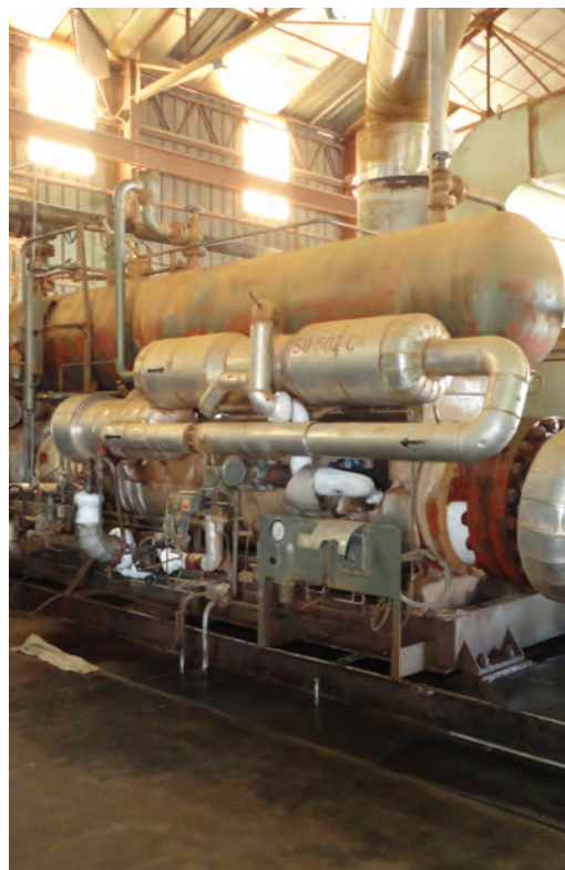
Stará technologie, která bude nahrazena novou chladicí jednotkou umístěnou v nové hale
