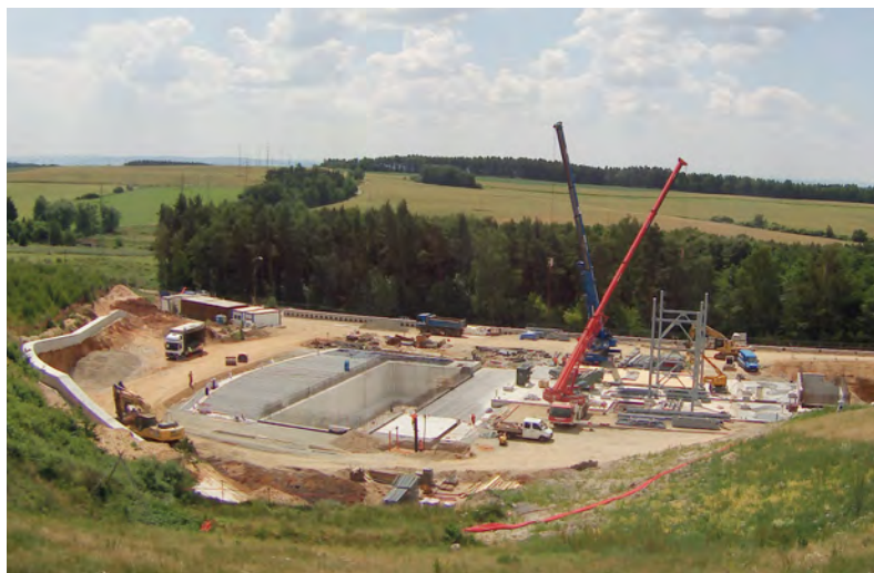
ZEVO Chotíkov na přelomu května a června 2014, pohled z východní strany. V popředí bunkr na skladování odpadu, za ním základová deska kotleny a stavba komínu (zatím do výšky cca 40 metrů z celkových 80)
